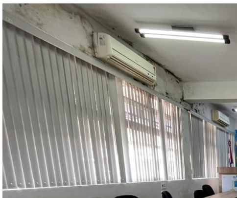
Figura 1: Infiltrações a serem "raspadas"
